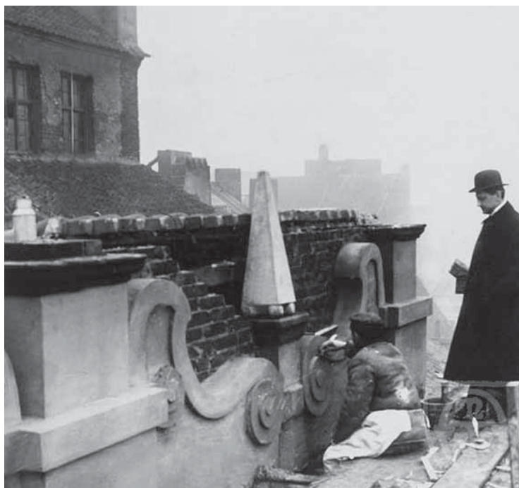
Ilustracja 1-49. Warszawa, Stare Miasto — dom Baryczków, attyka, prace konserwatorskie. Stan w 1912 roku. Fot. Z. Kalinowski. Zb. IS PAN, sygn. IS_PAN_BR0000007345
