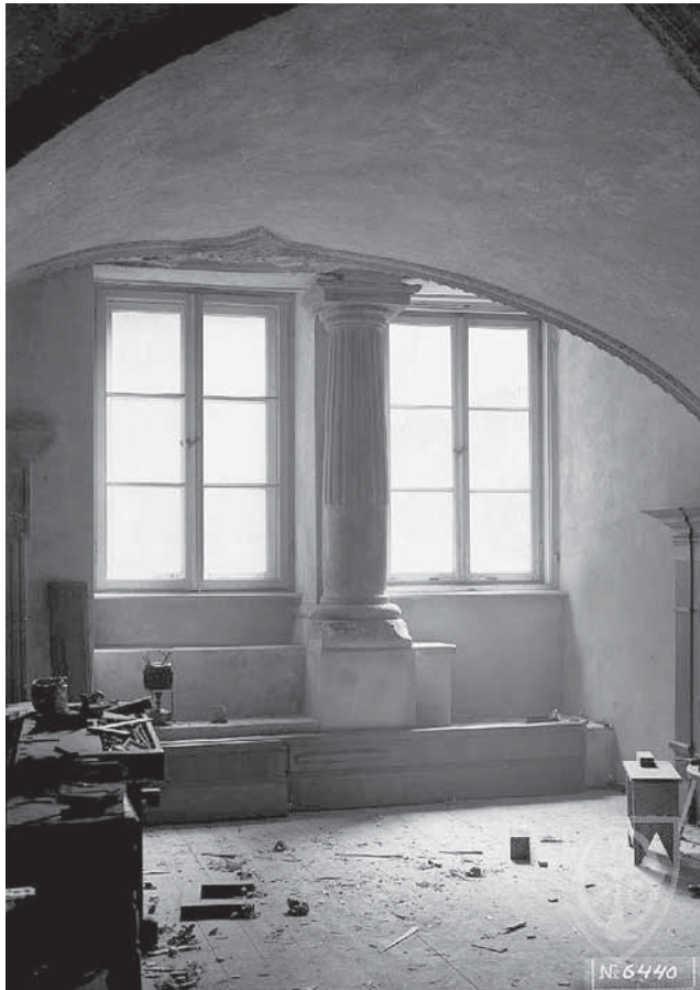
Ilustracja 1-47. Warszawa, Stare Miasto — dom Baryczków, przyziemie, wewnątrz tylnej izby w trakcie prac konserwatorskich. Stan około 1911 roku. Fot. S. Rakowski. Zb. IS PAN, sygn. IS_PAN_B0000006440
