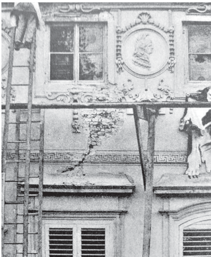
Ilustracja 1-5. Pałac w Wilanowie — korpus główny, elewacja ogrodowa z widocznym zarysowaniem muru. Stan około 1893 roku. Fot. W. Marconi (fragment), wg: W. Marconi, Album architektoniczny dawnych zabytków i pamiątek przeszłości , Warszawa 1894–1900. Z. VIII
